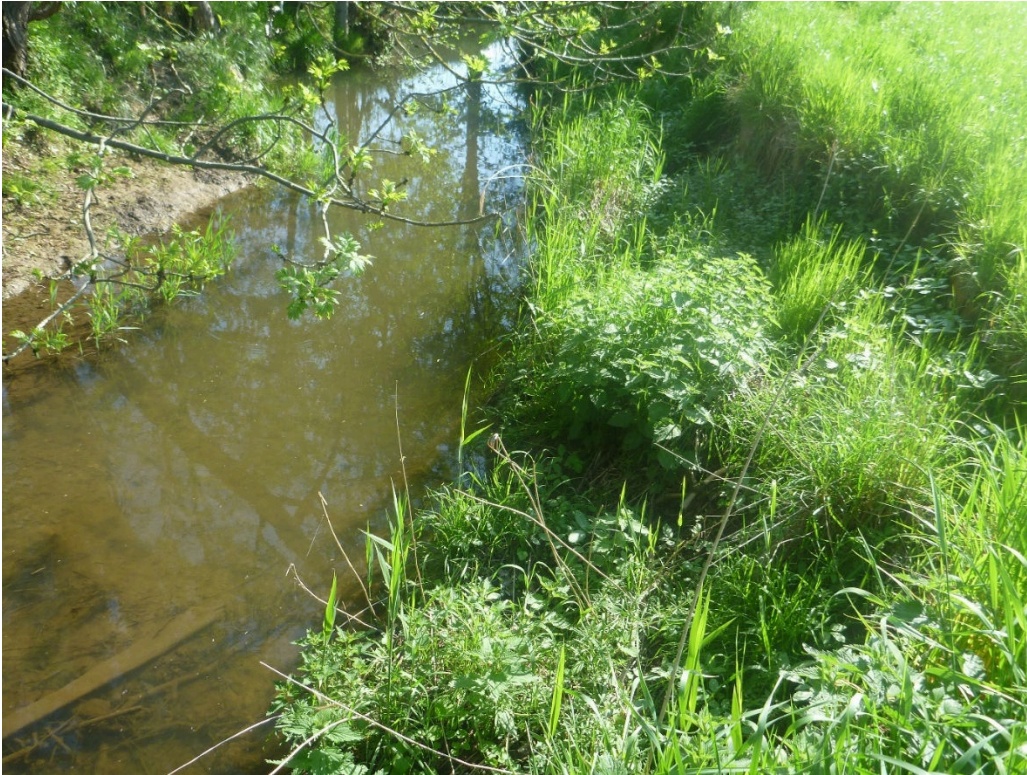
Abb. 29: Vorhandener Uferabbruch an der Aue (Nordufer) am Südrand des Plangebietes
